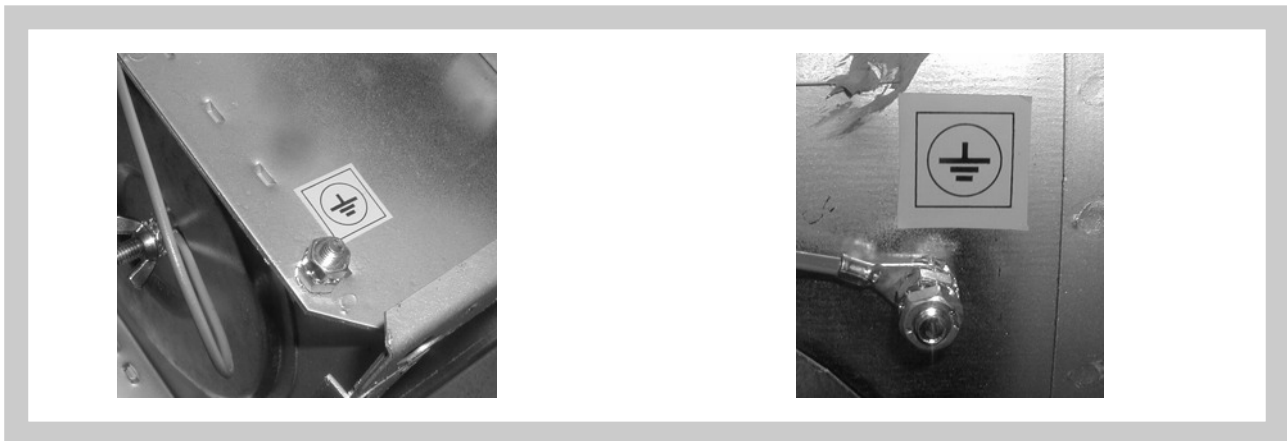
Obr. 4 Zemnicí šroub na požární klapce
