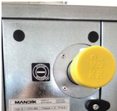
Kennzeichnung des Eingangs in den Wärmetauscher
