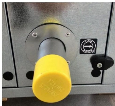
Kennzeichnung des Ausgangs des Wärmetauschers
